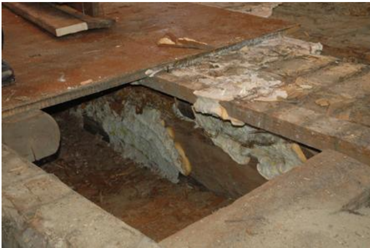
Kuva 25. Kirkon lattian alta paljastunut lattiasieni vaurio (JR).
