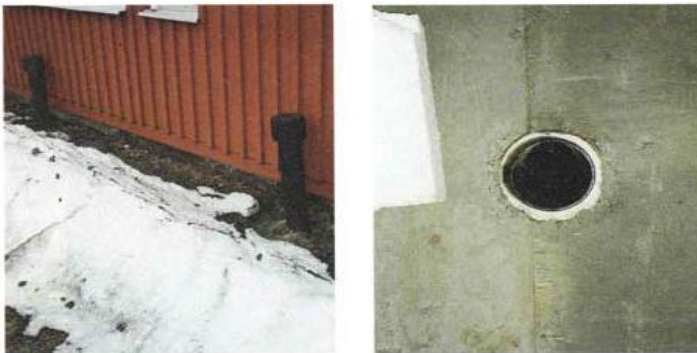
Kuva 14. Ryömintätilan tuuletusputket. Vasemmalla kuvassa on putket ulkopuolelta ja oikealla kuvassa on putken pää ryömintätilassa (Ympäristöopas 28, 1997). Kuvassa ympäröivä maanpinta on nostettu lähes puuverhoukseen asti.
