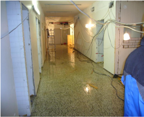
Kuva 7. Vesivahingon jälkiä käytävällä
