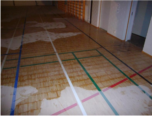
Kuva 6. Vesivahingon jälkiä liikuntasalissa
