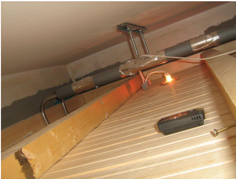
Kuva 4. Alakaton taustatilassa loggeri on sijoitettu paneelialakaton päälle. Kuvan alakattotilassa oli runsaasti tilaa loggerin sijoittelulle.
